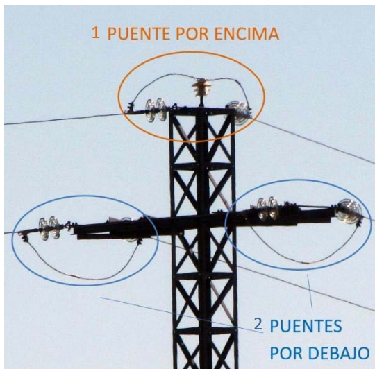
Figura 12. Cruceta en cruz (tipo 1) , con aisladores de vidrio, con 2 platos, un puente por encima y dos por debajo.
