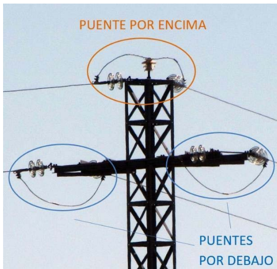
Figura 12. Cruceta en cruz (tipo 1), con aisladores de vidrio, con 2 platos, un puente por encima y dos por debajo.
